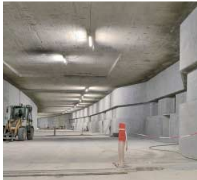
1 Eine Deckenbekleidung mit Tunnel-Brandschutzplatten aus Glasfaserleichtbeton sorgt im Tunnel Flughafen Tegel für Sicherheit bei Feuer. Die seitlich in einer Nische der Tunnelwand verlaufenden Kabel für die Tunneltechnik werden ebenfalls mit einer geeigneten Abdeckung vor Feuer geschützt
